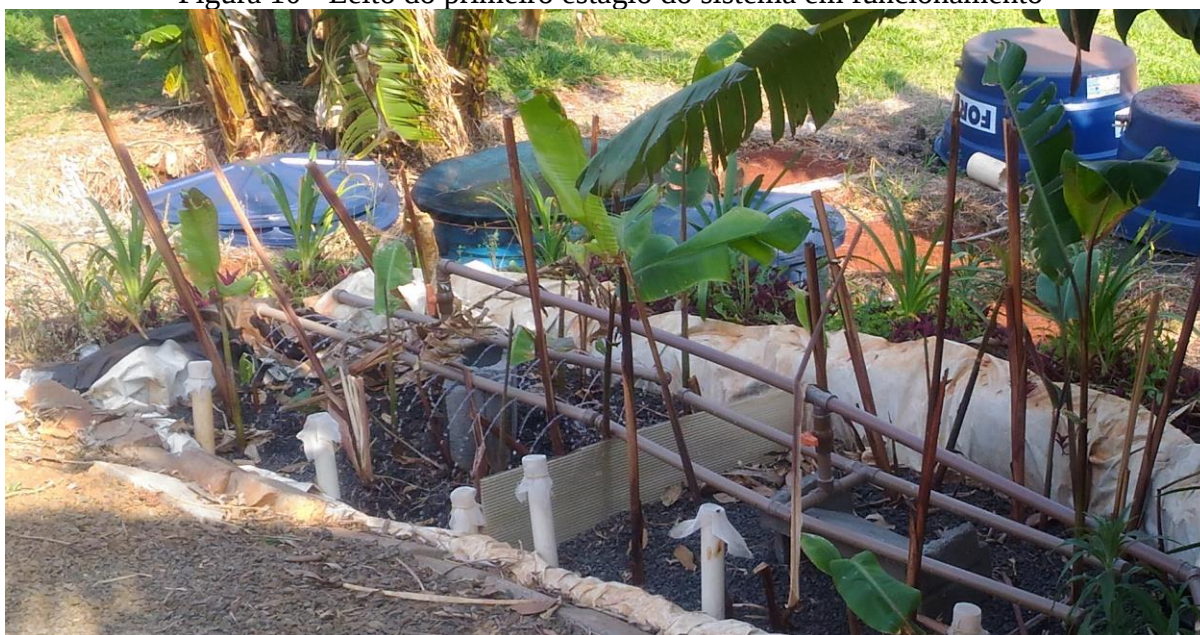
Figura 10 - Leito do primeiro estágio do sistema em funcionamento
