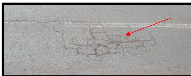
Figura 12- Defeito na seção 15 Fonte: Autoria própria.
