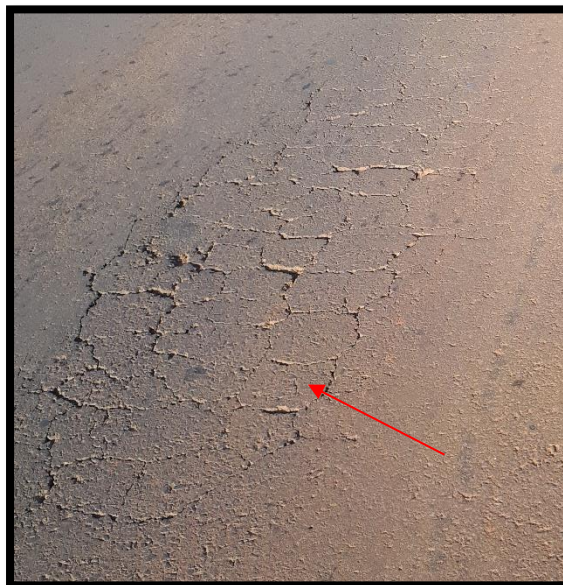
Figura 29- Defeito na seção 84 Fonte: Autoria própria.
