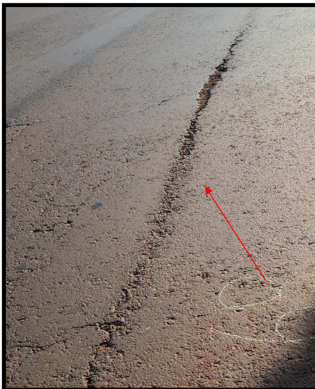
Figura 47- Defeito na seção 68 Fonte: Autoria própria.
