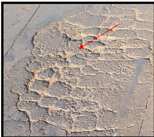
Figura 27- Defeito na seção 82 Fonte: Autoria própria.
