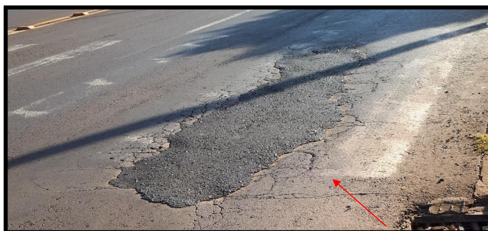
Figura 44- Defeitos na seção 52 Fonte: Autoria Própria.
