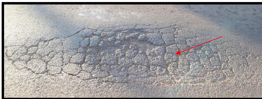
Figura 15- Defeito na seção 18 Fonte: Autoria própria.
