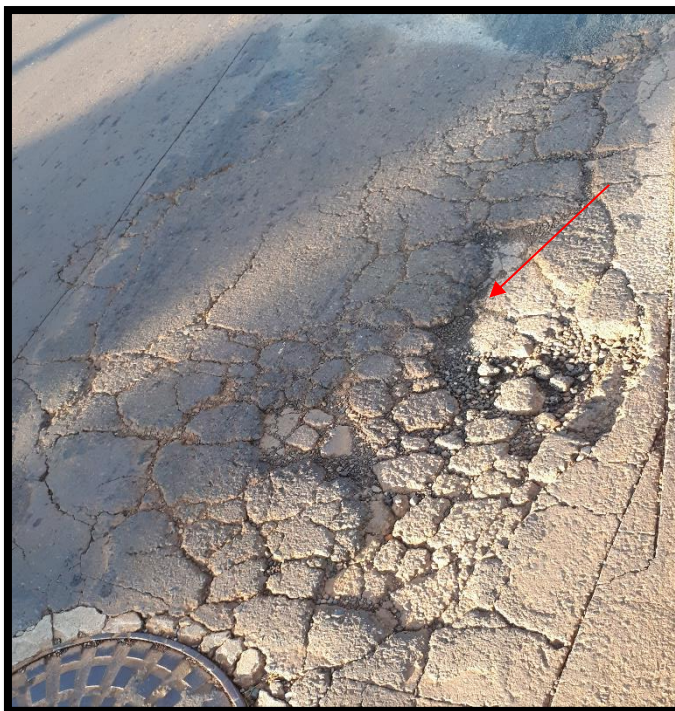
Figura 21- Defeito na seção 48 Fonte: Autoria própria.
