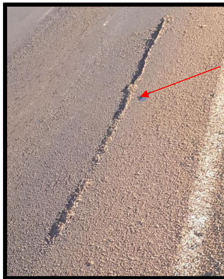
Figura 17- Defeito na seção 22 Fonte: Autoria própria.
