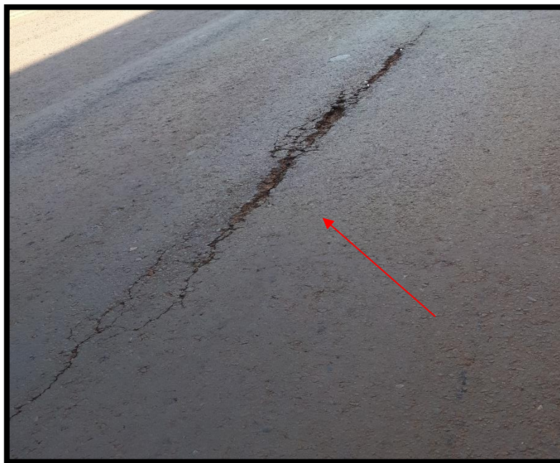
Figura 48- Defeito na seção 69 Fonte: Autoria própria.
