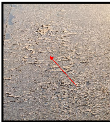
Figura 32- Defeito na seção 92 Fonte: Autoria própria.
