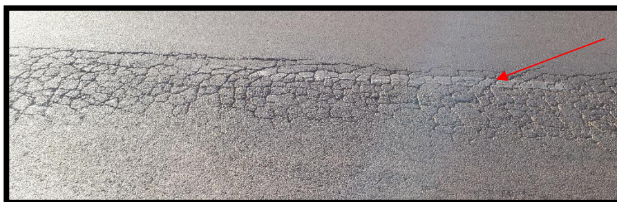
Figura 19- defeito na seção 26 Fonte: Autoria própria.
