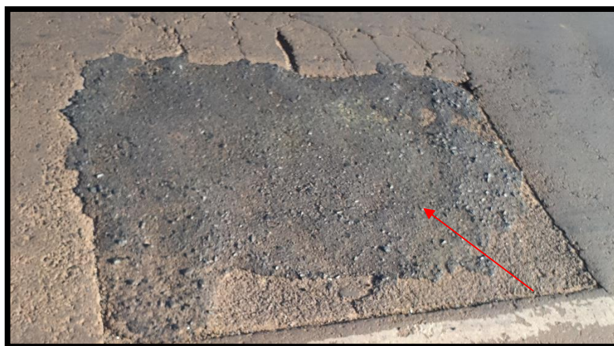
Figura 43- Defeitos na seção 50 Fonte: Autoria própria.
