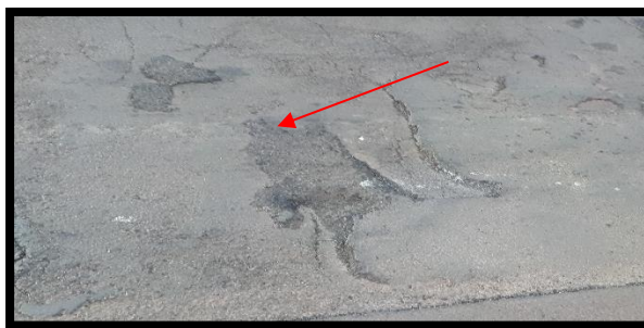
Figura 5- Defeito na seção 1 Fonte: Autoria própria.
