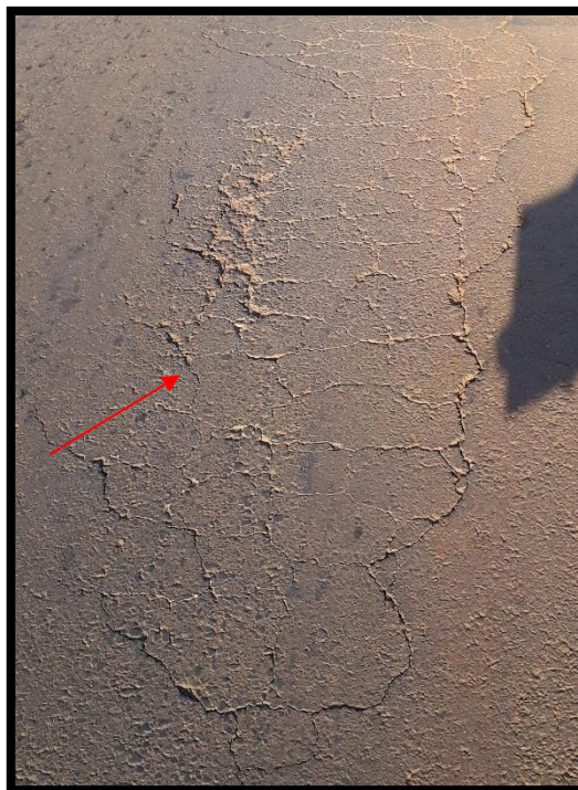
Figura 26- Defeito na seção 81 Fonte: Autoria própria.
