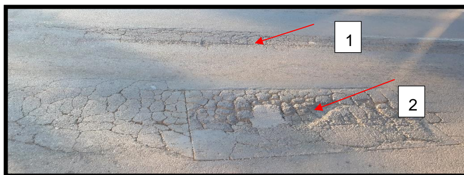
Figura 14- Defeitos na seção 17 Fonte: Autoria própria.
