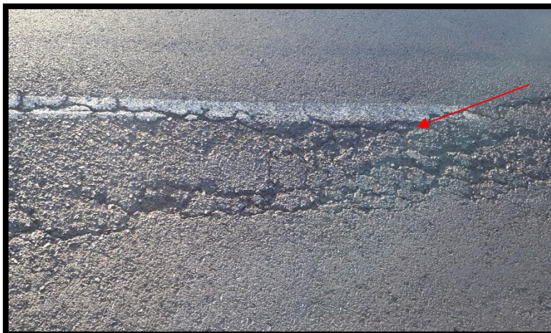
Figura 8- Defeito na seção 10 Fonte: Autoria própria.
