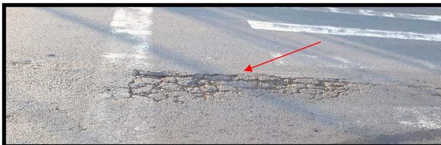
Figura 13- Defeito na seção 16 Fonte: Autoria própria.
