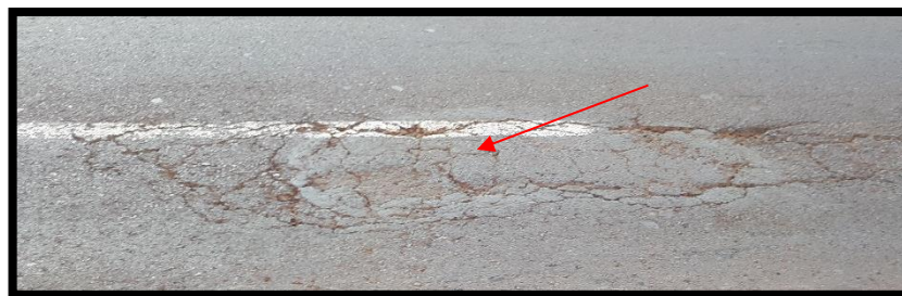
Figura 11- Defeito na seção 14 Fonte: Autoria própria.
