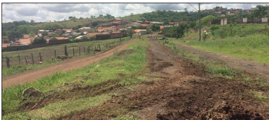
Figura 24 - Avenida da Integração após paralização da obra. Fonte: A Autora. 2015.
