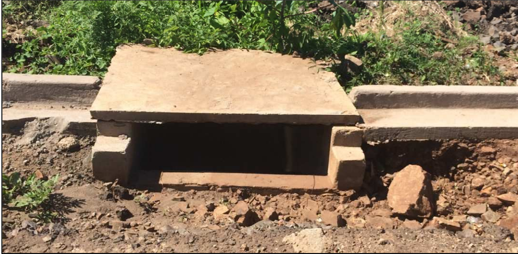
Figura 42 - Boca de lobo invadindo o alinhamento da rua. Fonte: A Autora. 2015.
