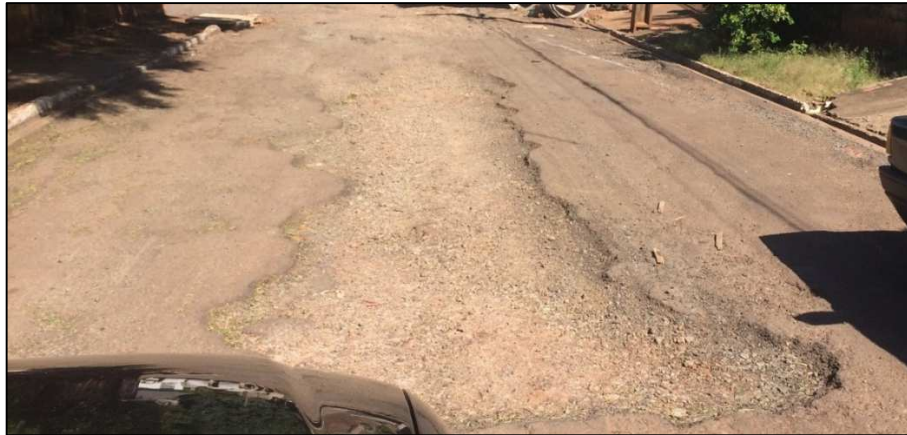
Figura 33 - Valas fechadas com material indevido. Fonte: A Autora. 2015.
