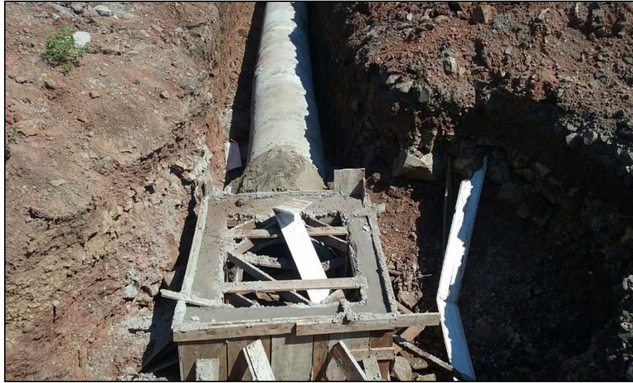
Figura 27 - Escavações deixadas abertas e poços de visita não finalizado. Fonte: A Autora. 2015.
