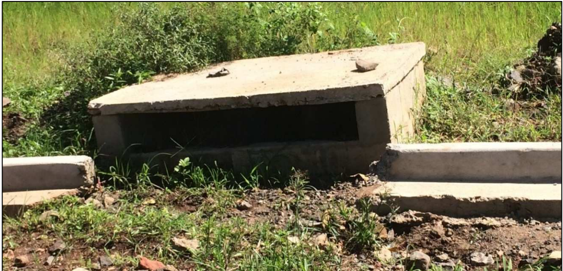
Figura 43 - Boca de lobo acima do nível da guia. Fonte: A Autora. 2015.
