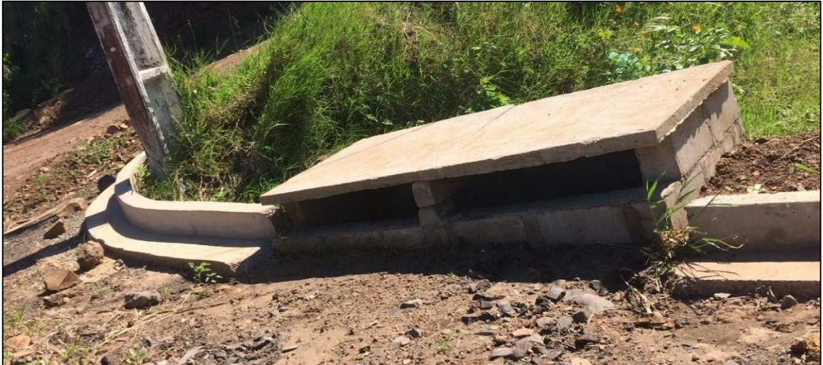
Figura 44 - Boca de lobo acima do nível da guia. Fonte: A Autora. 2015.
