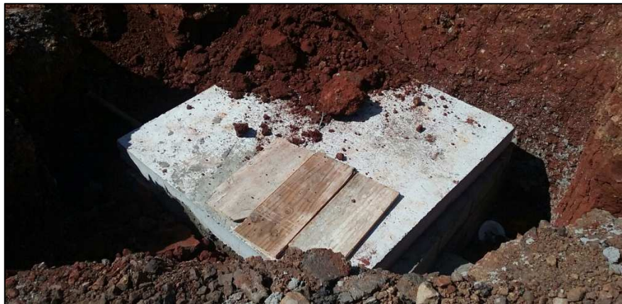
Figura 26 - Bocas de lobo sem acabamento e escavação em desmoronamento. Fonte: A Autora. 2015.
