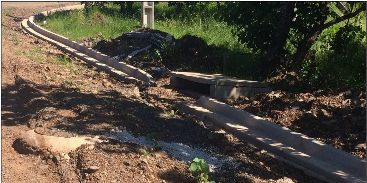
Figura 41 - Boca de lobo desalinhada com a guia III. Fonte: A Autora. 2015.
