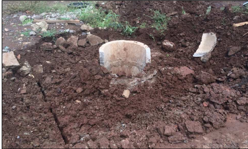
Figura 25 - Tubos de concreto quebrados deixados no local. Fonte: A Autora. 2015.
