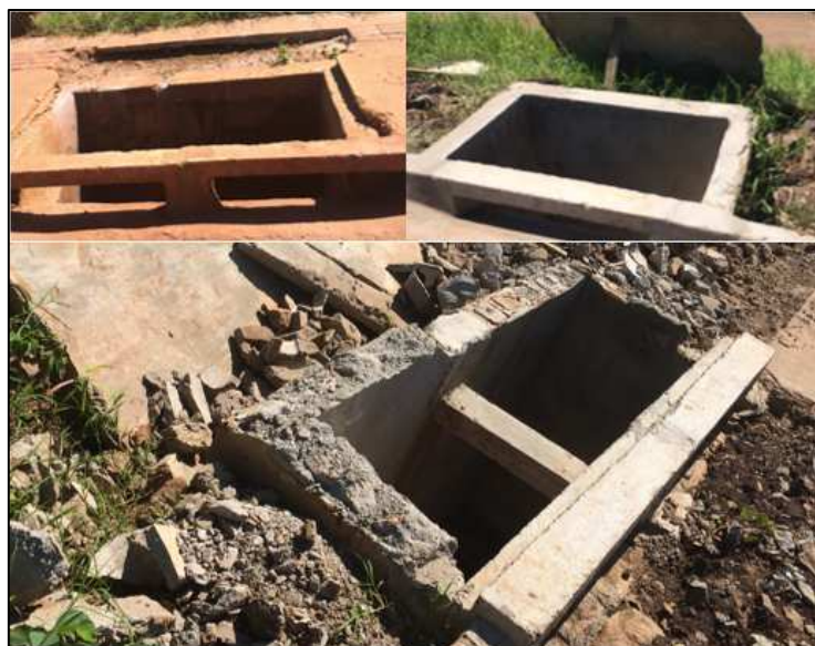
Figura 34 - Bocas de lobo deixadas abertas. Fonte: A Autora. 2015.
