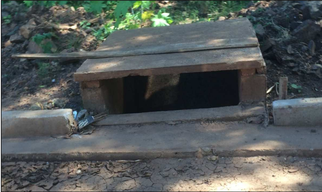
Figura 40 - Entrada da boca de lobo desalinhada com a guia. Fonte: A Autora. 2015.
