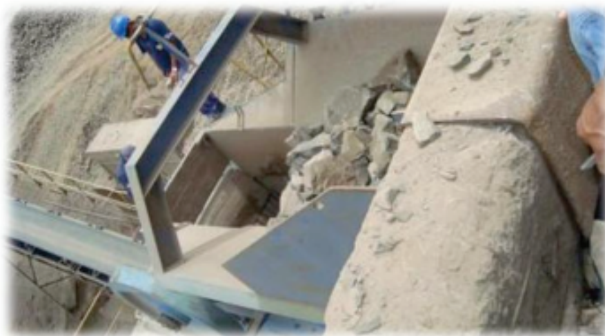
Figura 3 - Abastecimento do britador primário
