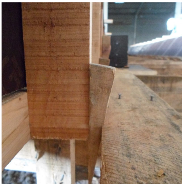
Figura 65 – Detalhe do encunhamento entre guia e travessa na base lateral da fôrma Fonte: O autor, 2013
