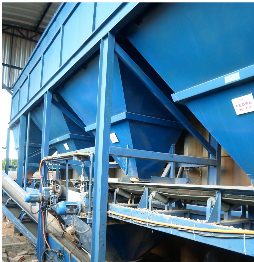
Figura 57 – Central de dosagem para produção de concreto Fonte: O autor, 2013.
