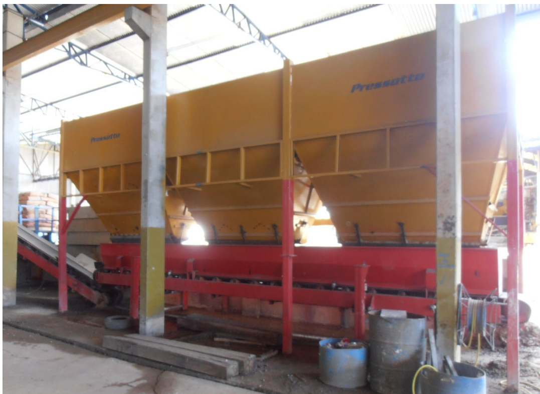
Figura 41 – Central dosadora de concreto Fonte: O autor, 2013.
