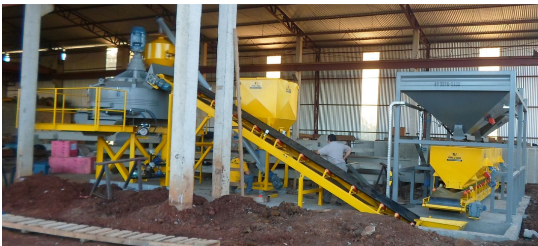
Figura 70 – Central dosadora de concreto Fonte: O autor, 2013
