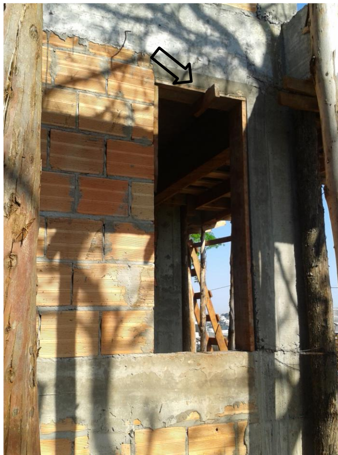
Figura 37: Espaçamento entre a viga e a esquadria em obra Fonte: Autoria Própria (2015).
