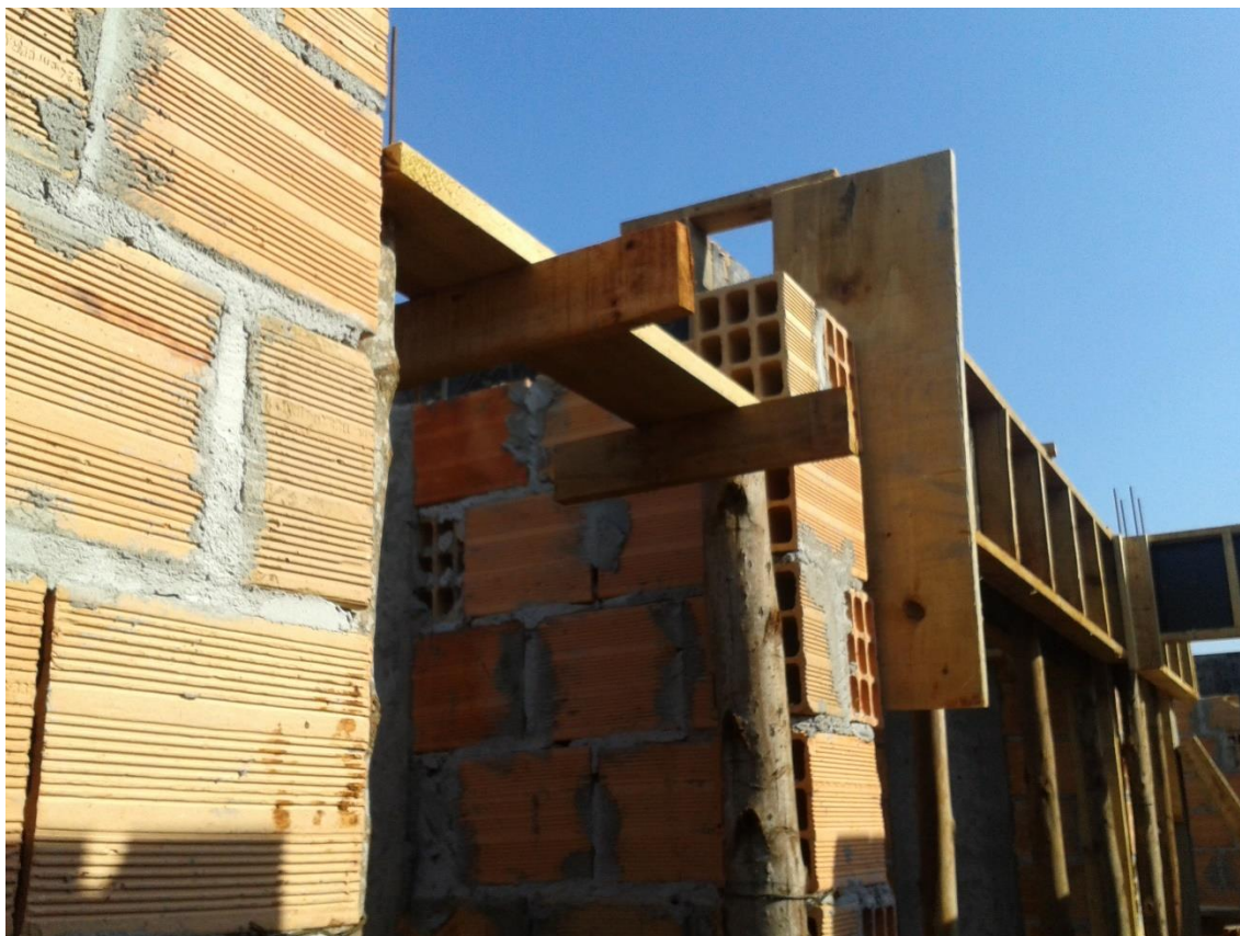
Figura 56: Demonstração da viga V9 passando sob o banheiro na obra Fonte: Autoria Própria (2015).
