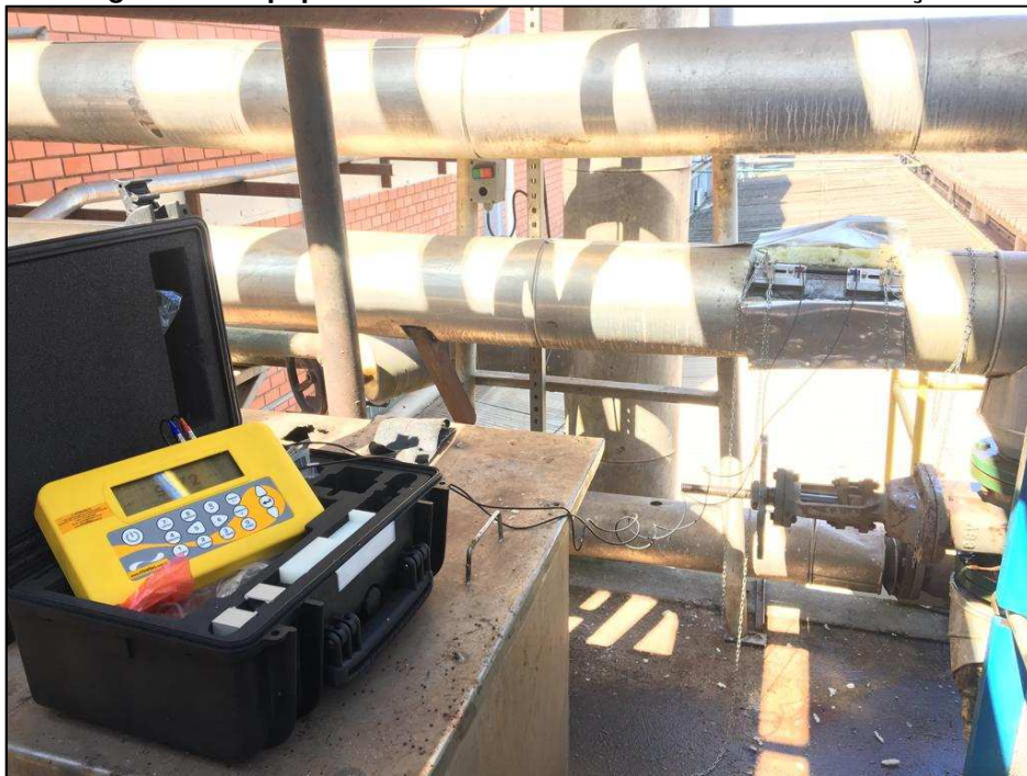
Figura 48 - Equipamento instalado em trecho reto da tubulação
