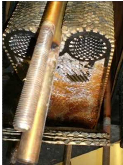
Figura 21 - Incrustação severa em placas
