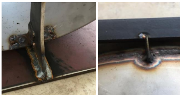
Figura 35 – Lacs de fixação da proteção da ventoinha
