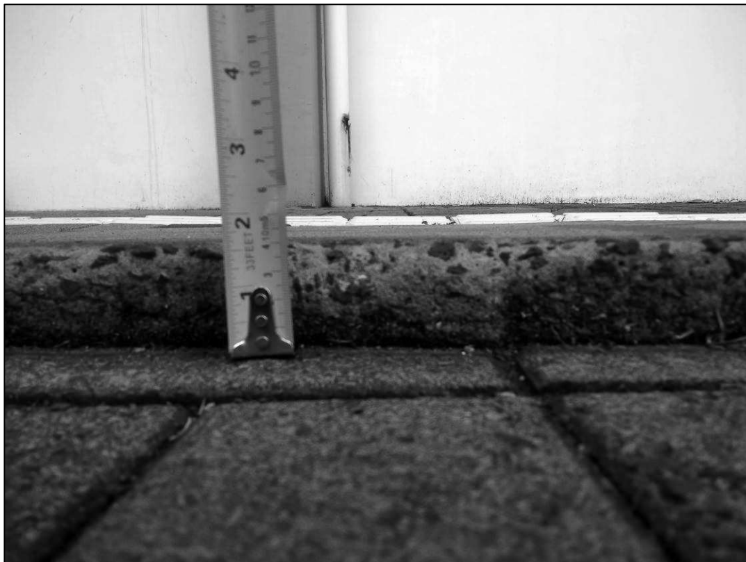
Fotografia 14 – Elevação de 4,2 cm na tampa C1.
