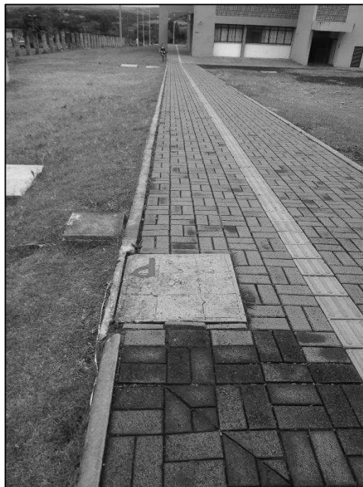
Fotografia 17 – Presença da Tampa C9 nos limites de instalação da guia de balizamento.
