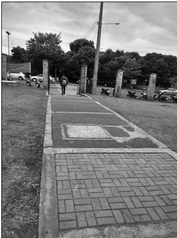
Fotografia 7 – Trecho com piso irregular e sem sinalização tátil visual
