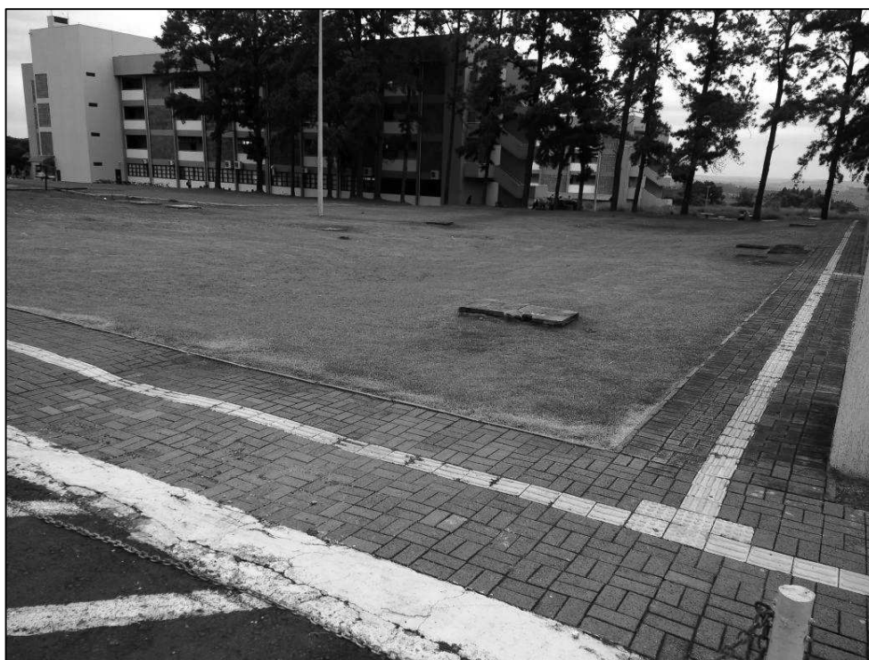
Fotografia 6 – Trecho com afundamento de piso
