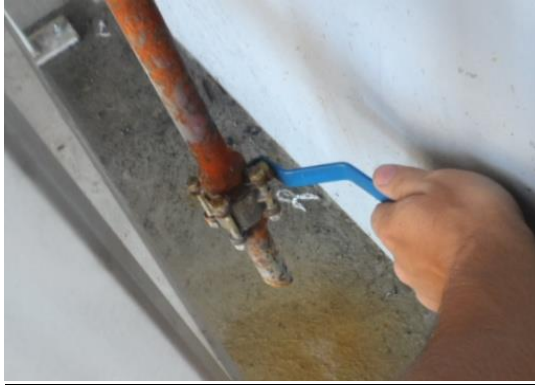
Fig. 26 – Válvula de drenagem.
