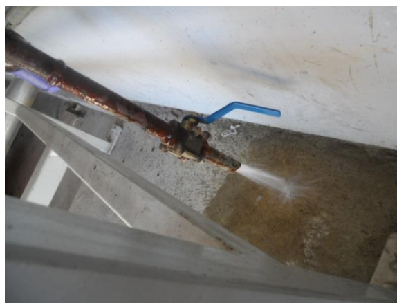
Figura 4 – Drenagem do condensado
