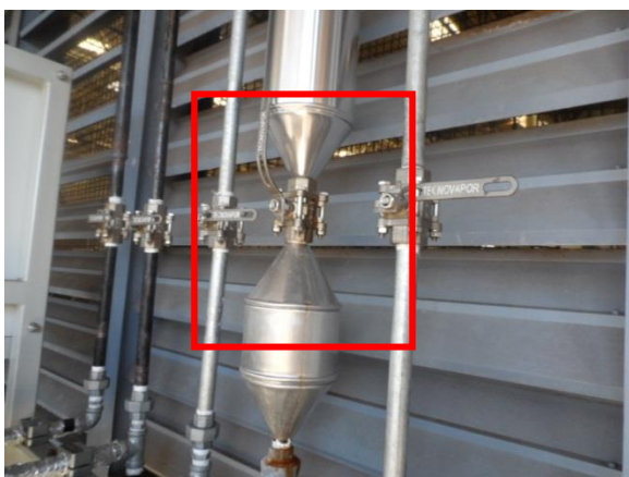
Figura 3 – Válvula de vapor aberta;
