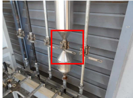
Figura 6 – Válvula de vapor fechada.
