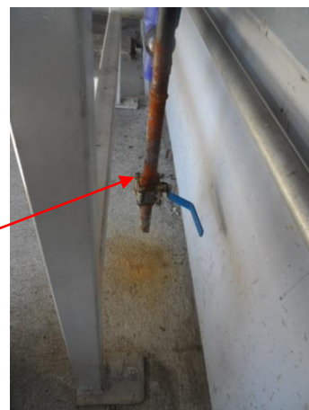
Figura 2 – Válvula de drenagem.
