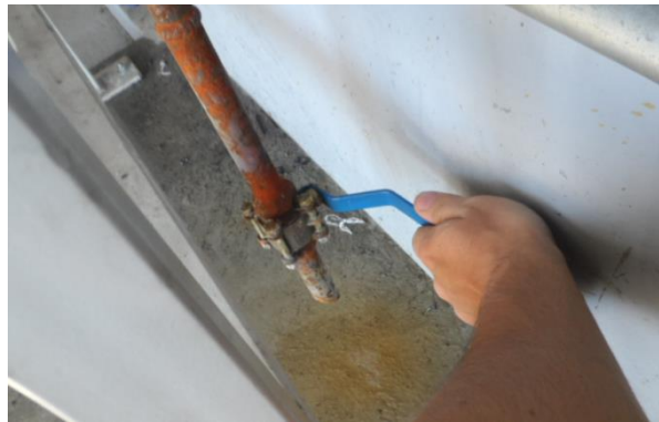
Fig. 7 – Válvula de drenagem fechada.
