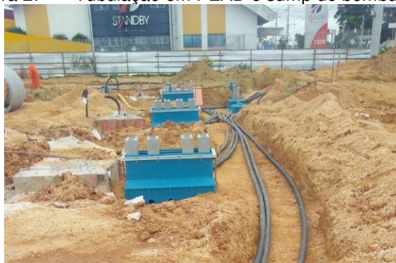
Figura 27 - Tubulação em PEAD e sump de bomba
