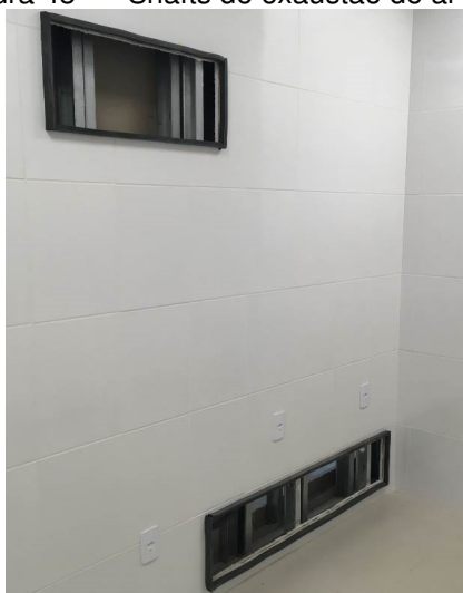
Figura 43 - Shafts de exaustão de ar
