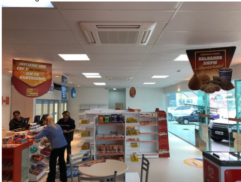
Figura 53 - Ar Condicionado Inverter instalado
