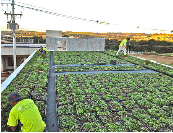
Figura 28 Telhado verde com sistema de módulos de drenagem recém-plantado. Fonte: flickr (2012)
