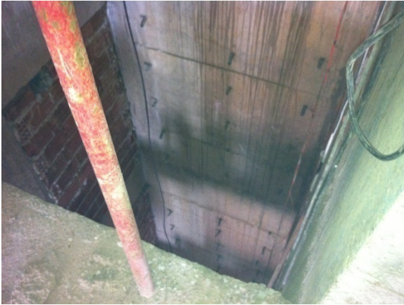
Figura 33: Ausência de proteção contra queda de altura no vão do elevador. Fonte: Arquivo pessoal, 2014.
