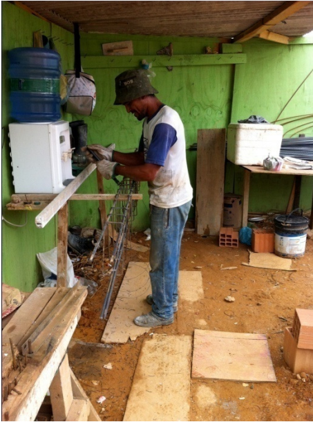
Figura 13: Dobragem e corte de vergalhões em local inapropriado. Fonte: Arquivo pessoal, 2014.
