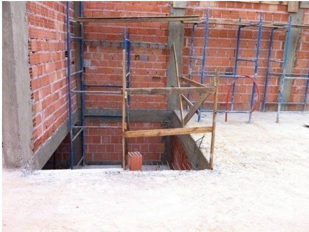
Figura 18: Ausência de proteção contra queda de altura e andaimes inapropriados. Fonte: Arquivo pessoal, 2014.
