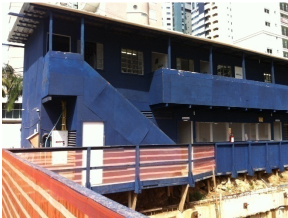
Figura 38: Proteção contra queda de altura. Fonte: Arquivo pessoal, 2014.
