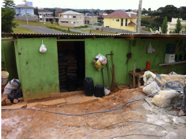
Figura 15: Lixo e entulhos na obra. Fonte: Arquivo pessoal, 2014.
