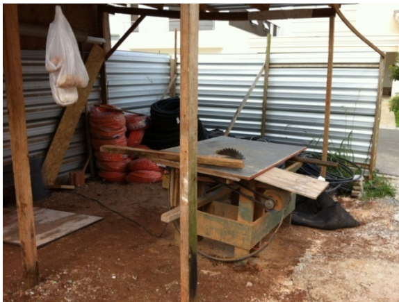
Figura 20: Bancada da serra circular não estava em piso resistente, nivelado e antiderrapante. Fonte: Arquivo pessoal, 2014.
