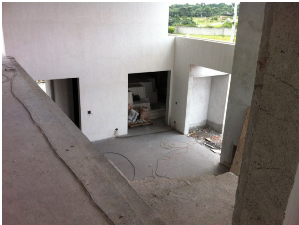
Figura 6: Ausência de proteção contra queda de altura.
