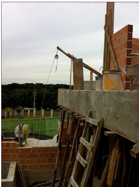
Figura 14: Escada de mão sem estar passando um metro do pav. superior. Fonte: Arquivo pessoal, 2014.
