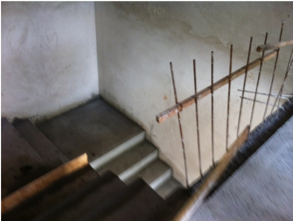
Figura 19: Proteção contra queda de altura de forma errada. Fonte: Arquivo pessoal, 2014.
