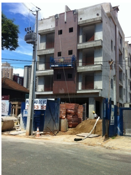
Figura 24: Ausência de proteção contra queda de altura. Fonte: Arquivo pessoal, 2014.
