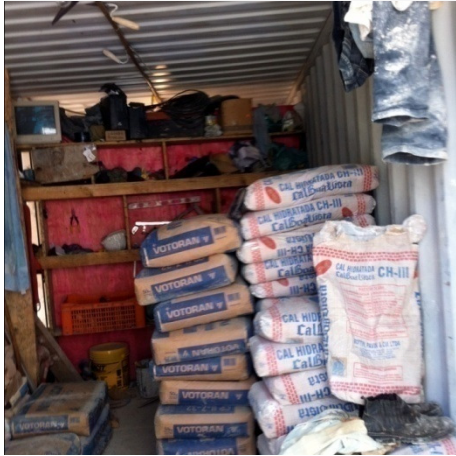
Figura 10: Armazenamento de materiais de forma e altura que não garantem estabilidade. Fonte: Arquivo pessoal, 2014.
