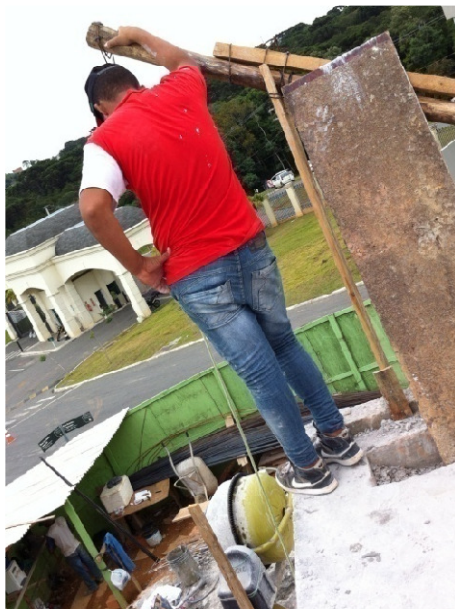
Figura 12: Ausência de proteção contra queda de altura, e func. sem EPI Fonte: Arquivo pessoal, 2014
