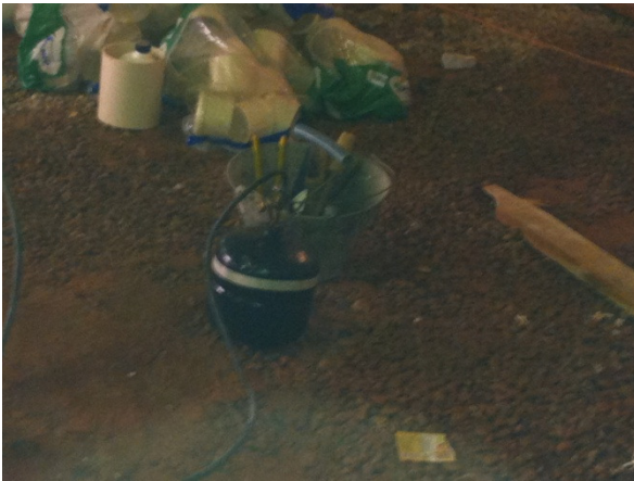
Figura 28: Recipientes para gases de solda não armazenados adequadamente. Fonte: Arquivo pessoal, 2014.
