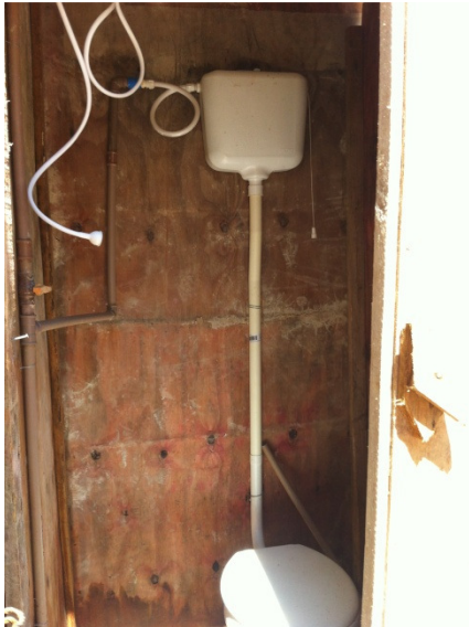
Figura 22: Instalação sanitária, vaso e chuveiro no mesmo ambiente
