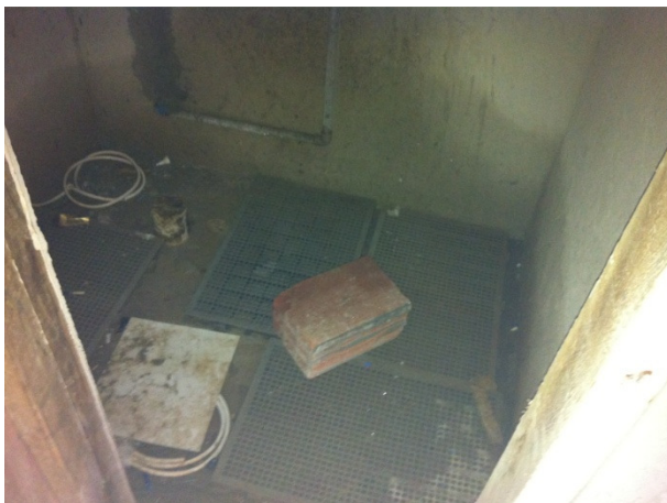
Figura 26: Instalações sanitárias inadequada. Fonte: Arquivo pessoal, 2014.
