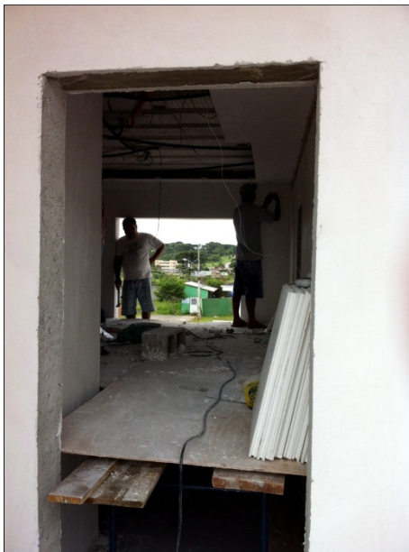
Figura 8: Trabalhadores sem EPI's.
