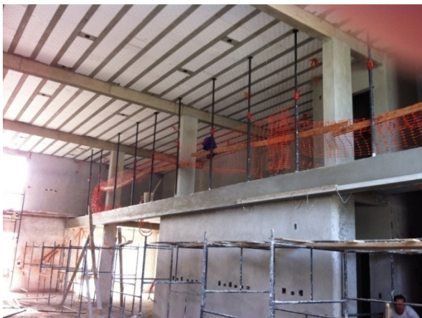
Figura 9: Ausência de proteção contra queda de altura. Fonte: Arquivo pessoal, 2014.
