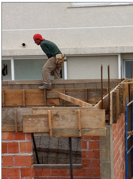
Figura 17: Ausência de proteção contra queda de altura e trabalhador sem cinturão de segurança. Fonte: Arquivo pessoal, 2014.
