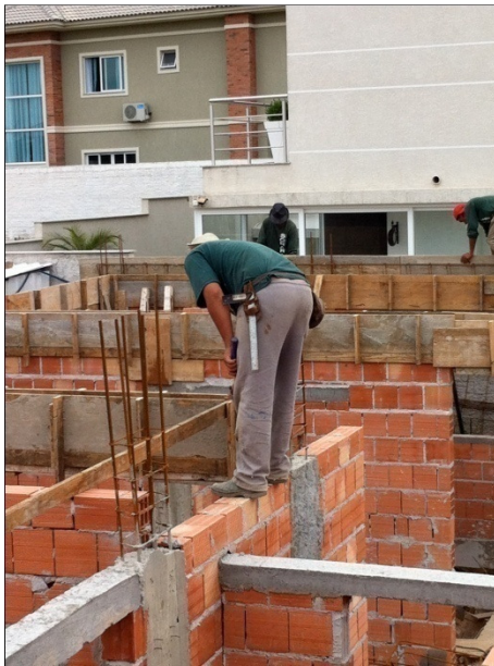
Figura 16: Ausência de proteção contra queda de altura. Fonte: Arquivo pessoal, 2014.
