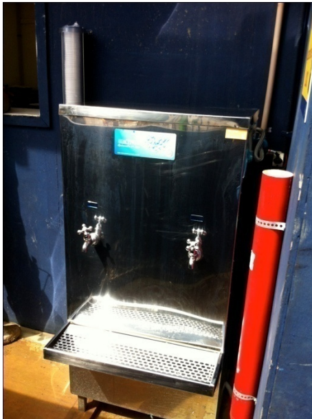
Figura 36: Água filtrada e fresca para os funcionários. Fonte: Arquivo pessoal, 2014.
