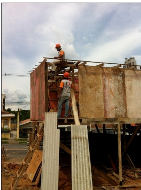
Figura 23: Trabalho em cobertura sem EPI
