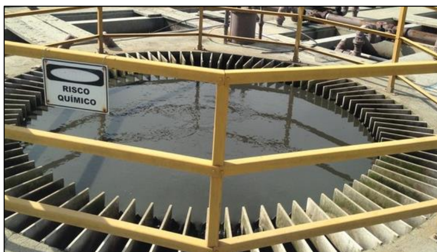
Figura 07: Foto do local do RALF na estação A onde constatou-se geração de gases.
