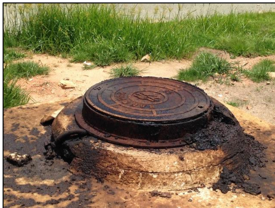
Figura 04: Corrosão provocada pelo H 2 S em um poço de visita de esgoto
