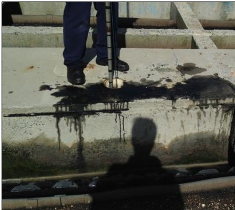
Figura 10: Coleta de lodo do Ralf para análise laboratorial pelo operador. Fonte: o autor (2017).
