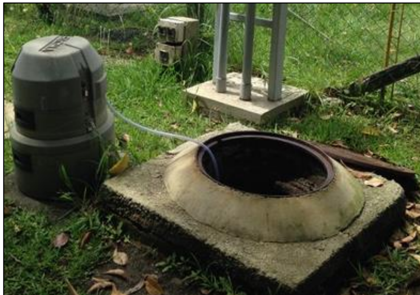
Figura 09: local de coleta do esgoto tratado após tratamento pelo RALF na estação B.
