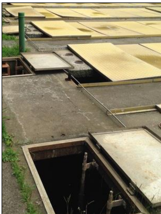
Figura 08: Local dos RALFs da Estação B em que identificou-se geração de sulfeto de hidrogênio.
