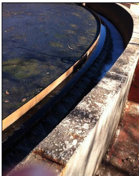
Figura 01: Saída do esgoto no RALF.
