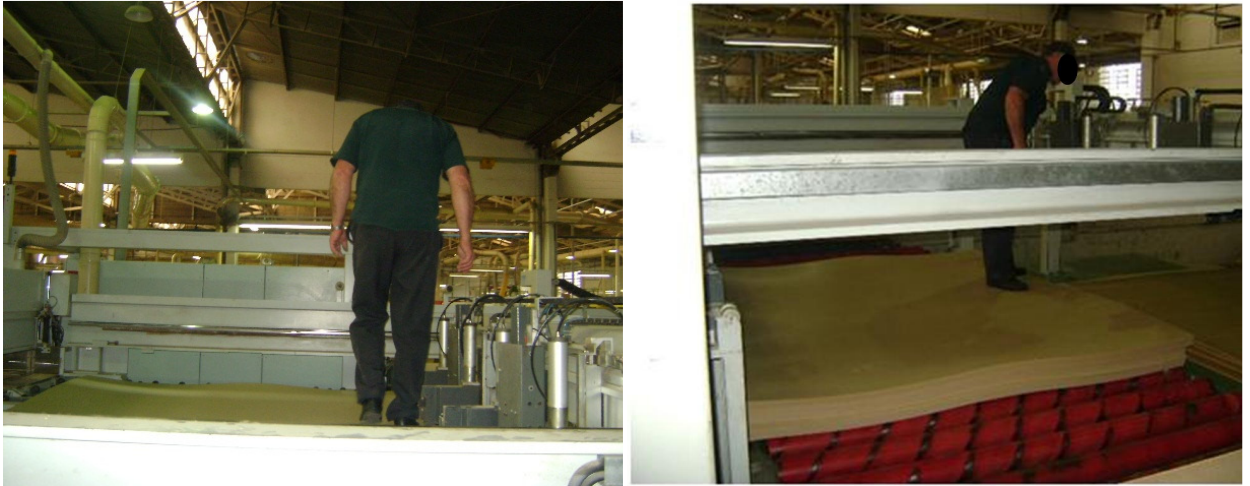
Figura 28 – Transitar sobre equipamento sem uso de EPIs adequados.
