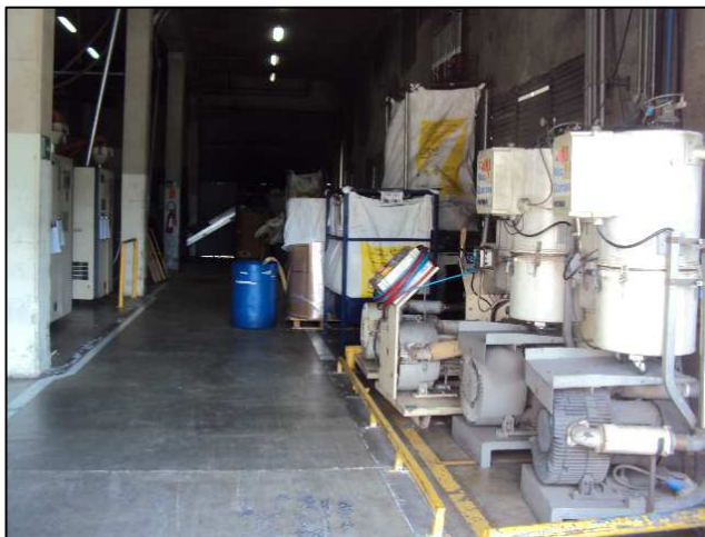
Figura 14: Bombas de vácuo
