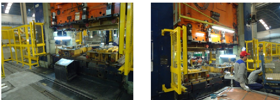
Figura 31 – Barreira de luz instalada após a realização do teste de escorregamento – Fonte: PPRPS da empresa XYZ
