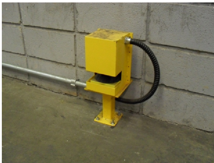
Figura 07 – Proteção Optoeletrônica horizontal – Scanner de Presença – Fonte: PPRPS empresa XYZ
