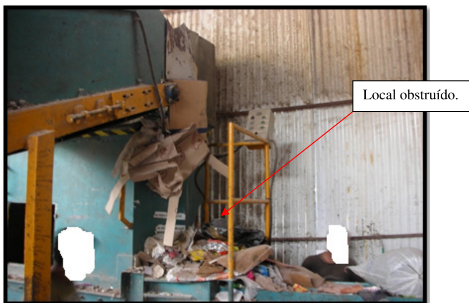
Figura 17 – Localização do botão de emergência.
