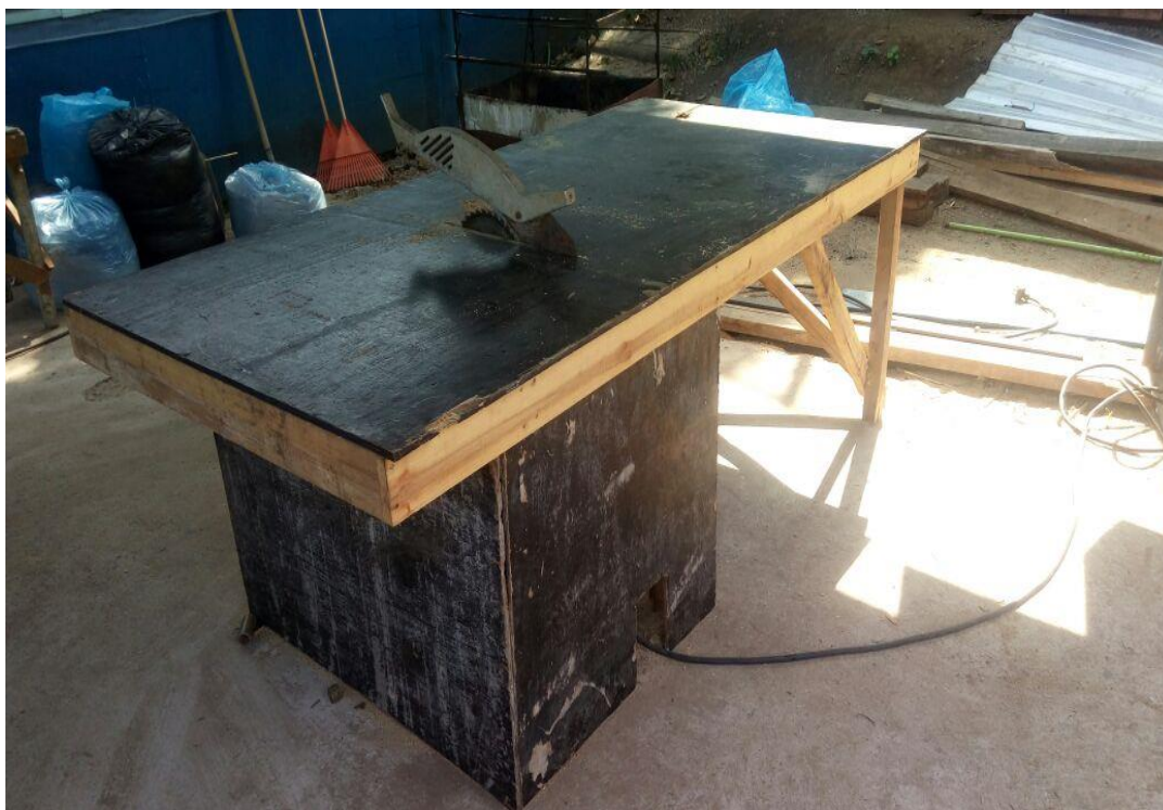
Figura 6 - Serra circular de bancada Obra 01 – Vista Anterior
