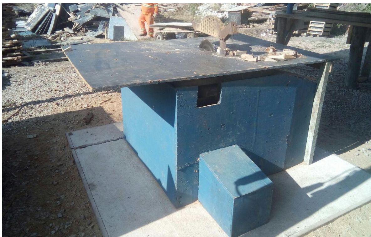
Figura 10 - Serra circular de bancada Obra 02– Vista Anterior
