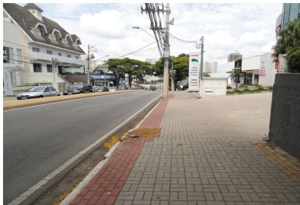
Figura 24 - Condição da Avenida São João Fonte: Autoria própria.
