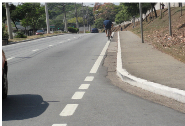
Figura 17 - Condição da Avenida dos Astronautas Fonte: Autoria própria.
