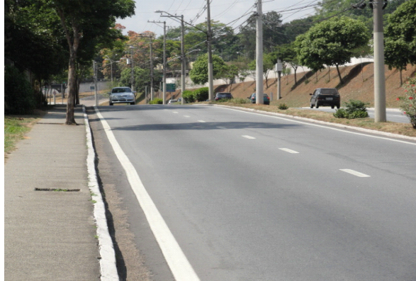
Figura 18 - Condição da Avenida dos Astronautas Fonte: Autoria própria.
