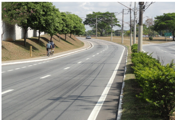
Figura 19 - Condição da Avenida dos Astronautas Fonte: Autoria própria.
