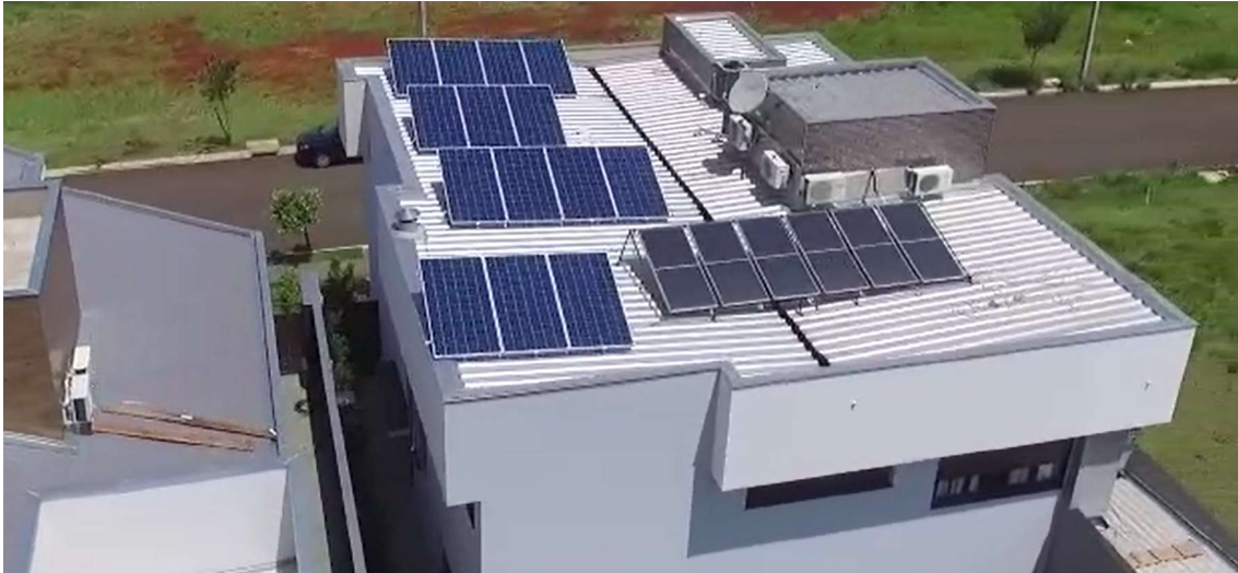
Figura 33: Foto da usina real instalada com os painéis voltados para o Norte. FONTE: Autoria Própria
