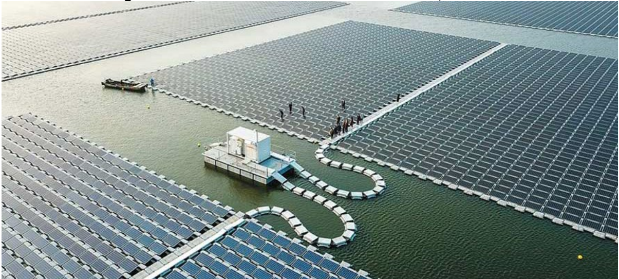
Figura 8 - Usina fotovoltaica flutuante em Huainan, na China.
