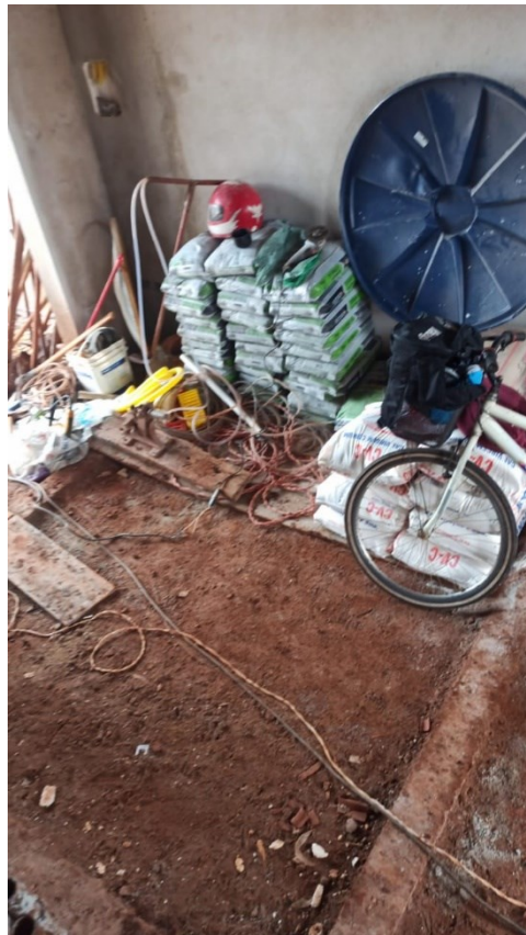
Figura 26: Fios elétricos amontoados
