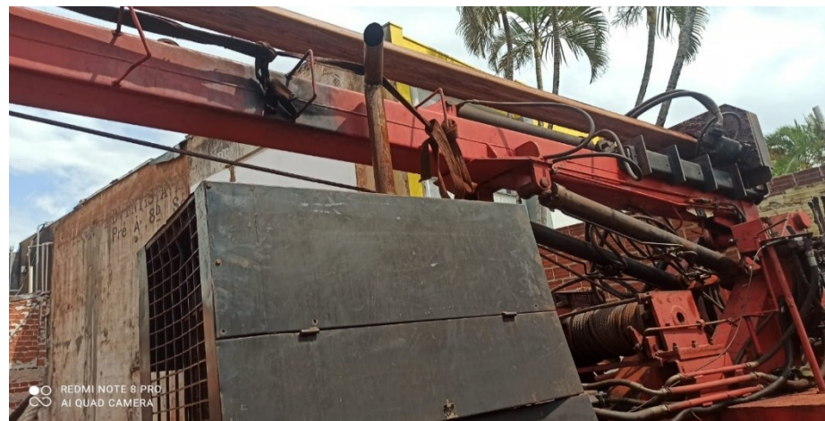
Figura 31: Parte exposta do maquinário
