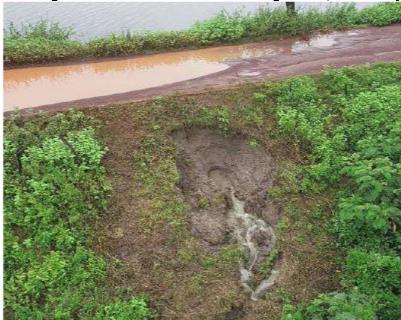
Figura 4 – Surgência indicando erosão tubular regressiva, talude de jusante.
