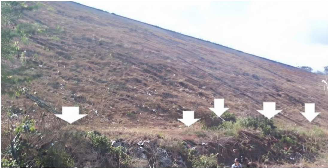
Figura 3 – Filtro de pé obstruído pela vegetação.
