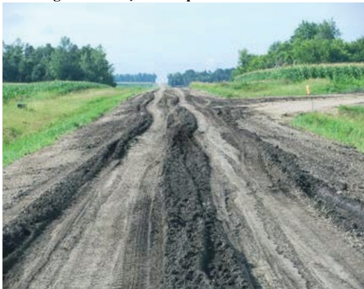
Figura 2 – Seção com plasticidade excessiva
