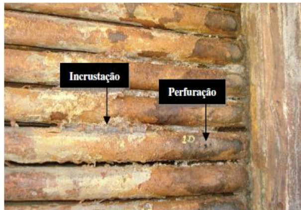
Figura 8 - Detalhe do desgaste corrosivo em aquecedor tubular. Fonte: Kejelin (2013).
