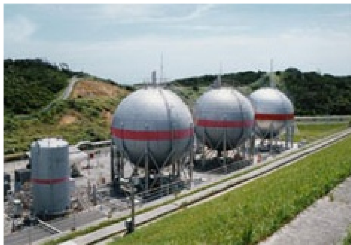
Figura 4.3: Tanques esféricos para armazenamento de hidrogênio
