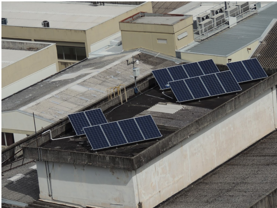
Figura 12 – Planta Fotovoltaica Utilizada
