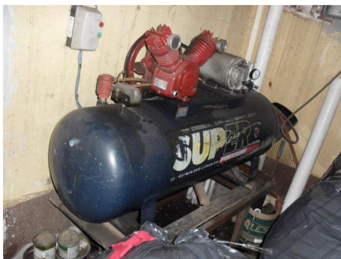
Figura 7- Compressor de ar. Fonte: Aatoria própria, 2013.
