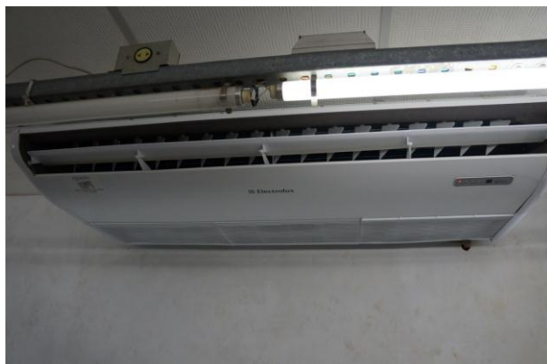
Figura 8- Ar condicionado Fonte: Aatoria própria, 2013.
