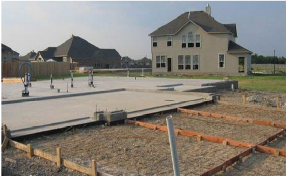
Fotografia 4 – Radier com instalações hidrossanitárias aparentes Fonte: Oliveira (2012, p. 19).
