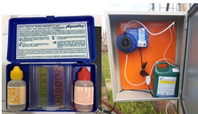
Figura 8. Indicador de cloro e pH (A) e bomba dosadora de cloro (B).
