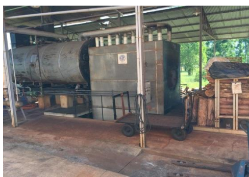
Figura 2. Caldeira com a manutenção em dia.
