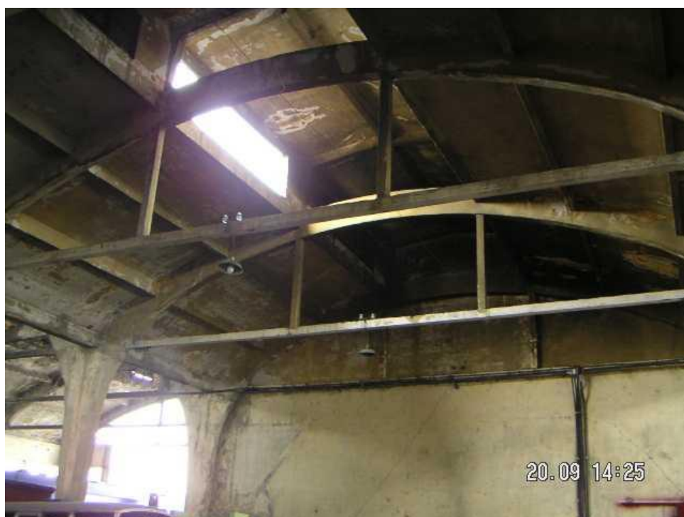
Figura 104: Depósito de Máquinas e Litorinas. Infiltrações e degradação. Fonte: Acervo SEEC.
