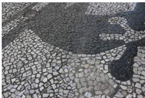
Figura 30 - imagem de trecho de calçamento da rua Ébano Pereira, em que é necessária a manutenção do petit pave .
