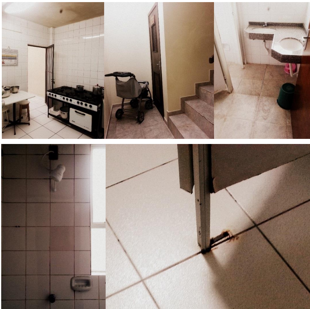
Fotografias 6. Fotos que revelam problemas arquitetônicos, de acessibilidade e manutenção na Casa de Maria. FONTE: Acervo do autor.
